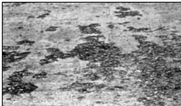
Descascamiento de las superficies de concreto
